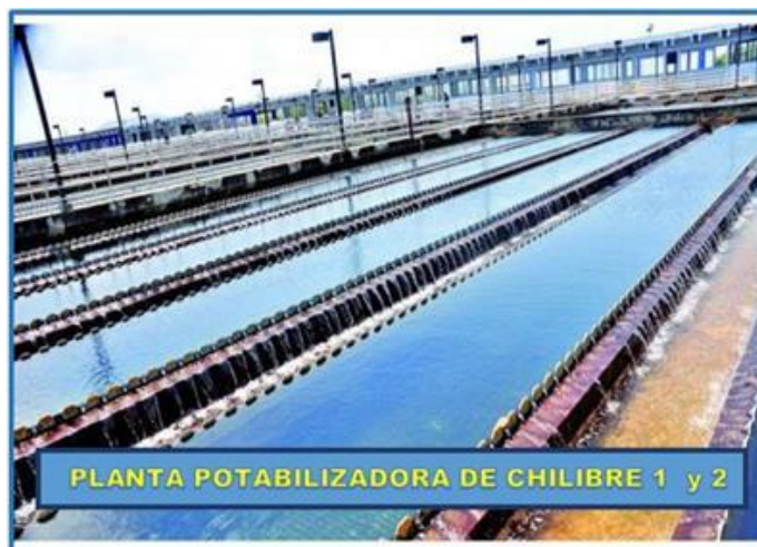
Ilustración 97. Planta Potabilizadora de Chilibre 1 y 2. Fotografía por Idaan. (IDAAN, s.f.)
