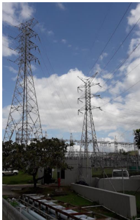
Ilustración 106. Torre eléctrica en EGESA Planta eléctrica Condado Del Rey. Fotografía por Luis Ortega en Google Maps.
