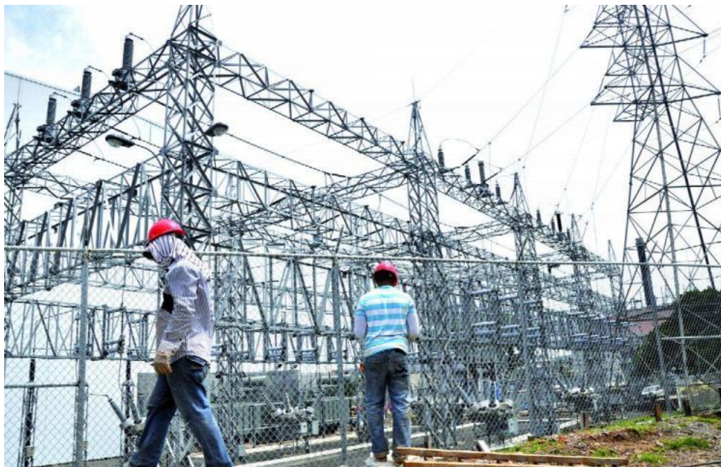
Ilustración 105. Subestación Panamá 1. Fotografía por Judith Peña en periódico “El Siglo”. (Peña, 2017)
